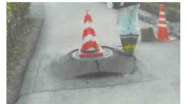
道路の陥没で浮いたマンホール
