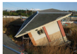
津波で傾いた公衆トイレ
